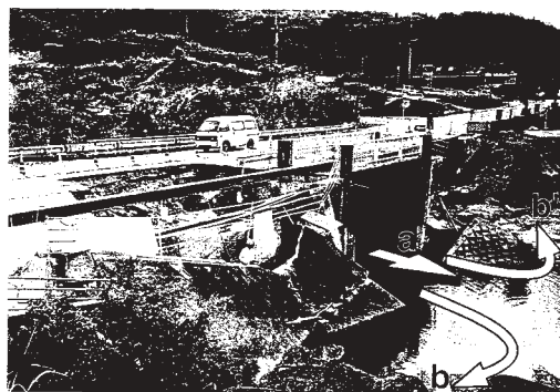
写真3 西之表市上石寺の道路決壊現場
