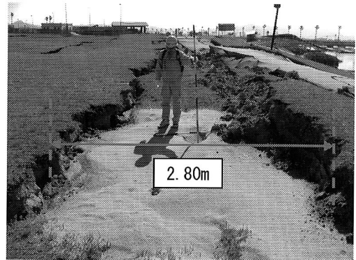
写真8 地割れ幅 2.80m(海の中道海浜公園)
