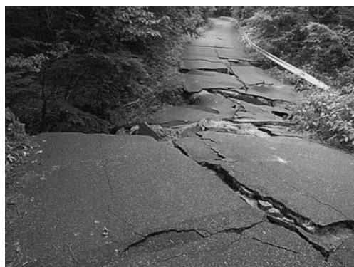
写真8 荒砥沢地すべり東方の稜線で発見された地表地震断層(活断層)。数mの右横ずれと北西側隆起を伴っている。
