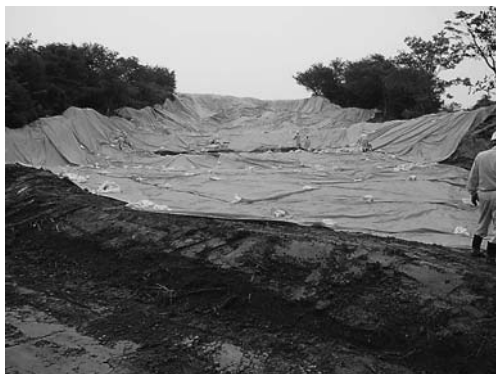
写真5 旧築館町館下で発生した谷埋め盛土の崩壊。
