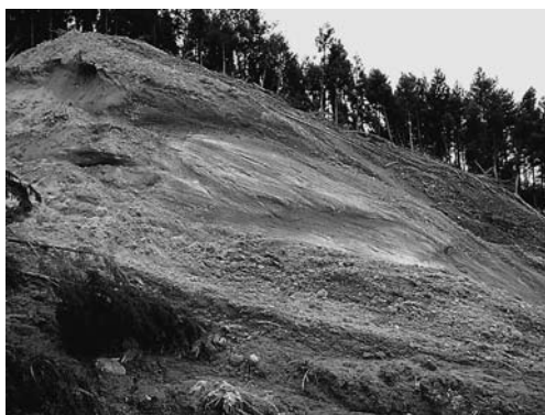
写真7 荒砥沢地すべりの対岸の尾根に残された水平な擦痕。地すべり本体がこの尾根に衝突した後、一部の土塊が向きを変えて貯水池方向(右方向)に向かった。その結果、この尾根自体も数m水平に移動した。
