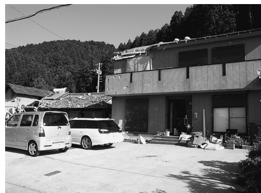
写真18 家屋の被害状況(尾崎町, 2006年9月 19日撮影)
