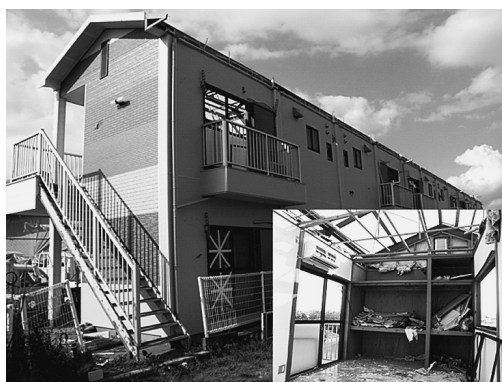
写真5 アパートの被害状況（浜町，2006年9月19日撮影）
