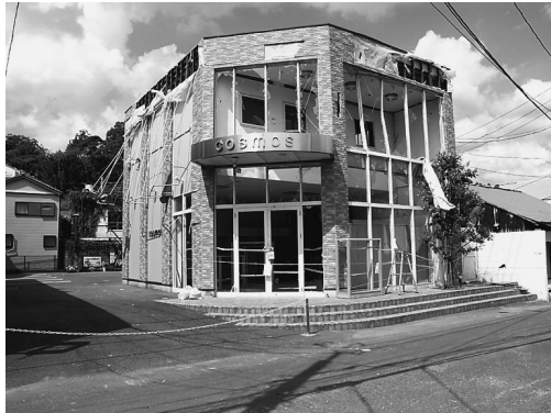
写真14 建物外装材および窓ガラスの被害状況 (栄町, 2006年9月19日撮影)
