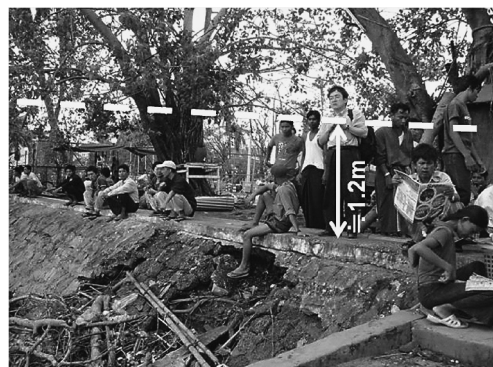
写真3 ヤンゴン・フェリー乗り場 (N16度46分3.53秒, E96度09分48.54秒) ヤンゴ市内の船の渡し場では、護岸を1.2m 超える高潮が押し寄せた。
