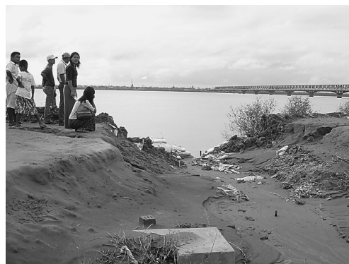
写真4 バゴー川左岸 (N16度46分58.84秒, E96度14分1.61秒) 高潮流下時の洗掘の跡と見られる。
