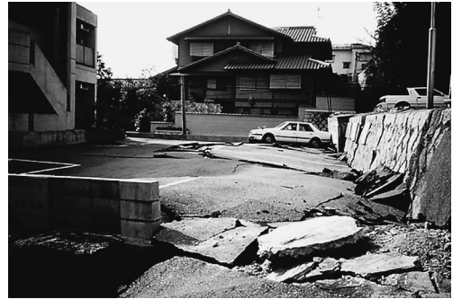
写真1 兵庫県南部地震における谷埋め盛土の地すべり(西宮市)。画面奥の民家と手前の道路の間(駐車場の部分)はかつて、深さ5m程度の谷であった。この谷埋め盛土は、画面の200mほど右から左へ数m移動し、画面左のマンションに当たって停止した。駐車場には、末端部の隆起に伴うクラックの発達が顕著である。ここは、現在では住宅地として使われている。
