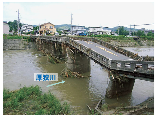
写真8 橋脚が傾いた新橋（山陽小野田市鴨庄，2010年7月16日撮影）
