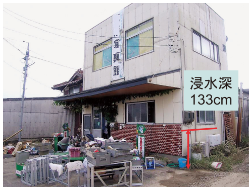
写真1 桜川右岸の写真店の被害状況 (山陽小野田市山川, 2010年7月16日撮影)
