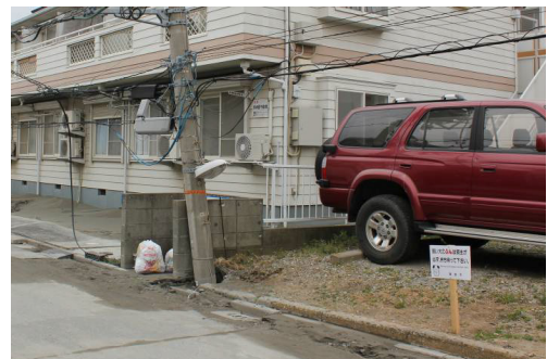
写真14 沈下した電信柱（浦安市今川）
