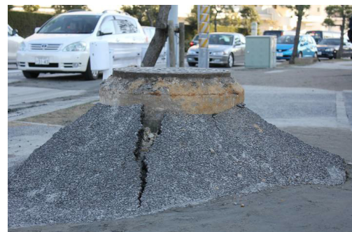
写真15 浮上ったマンホール（浦安市日の出）
