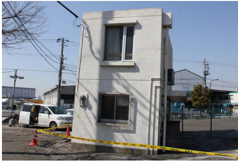
写真3 沈下・傾斜した交番（新木場）
