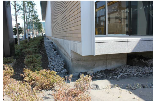
写真5 杭基礎建物の周辺地盤の沈下（新木場）
