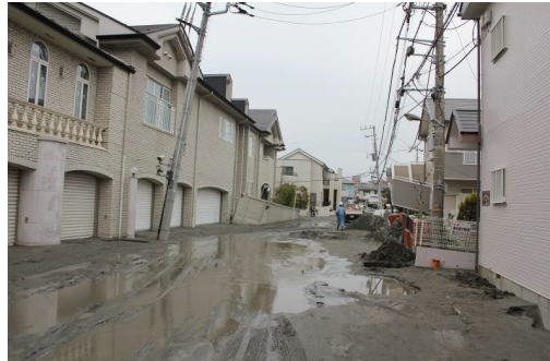
写真6 噴砂で覆われた道路（浦安市今川）
