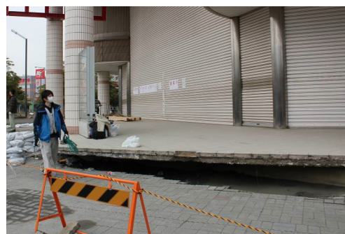
写真10 杭基礎建物の周辺地盤の沈下 (浦安市明海)
