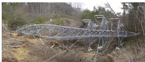
図3-4 地震によって倒壊した送電線鉄塔
