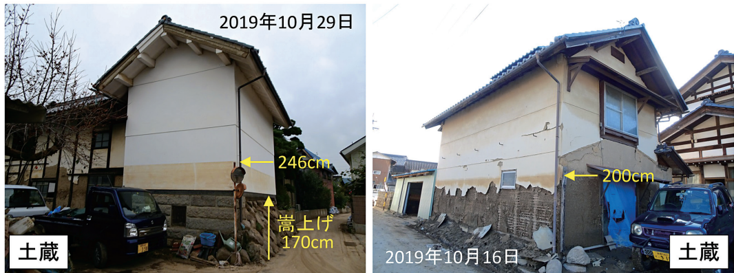
写真7 赤沼における土蔵の被災状況 (2019年10月16・29日撮影)
