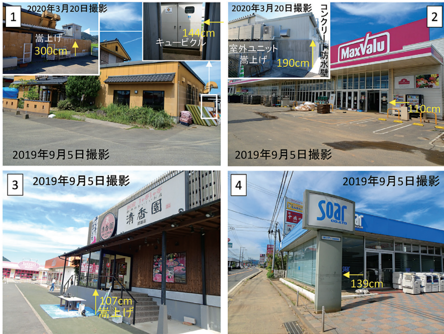
写真10 「複合商業施設メリーランド武雄」(1～3)と隣接する店舗(4)における浸水被害の状況(2019年9月5日・2020年3月20日撮影)
