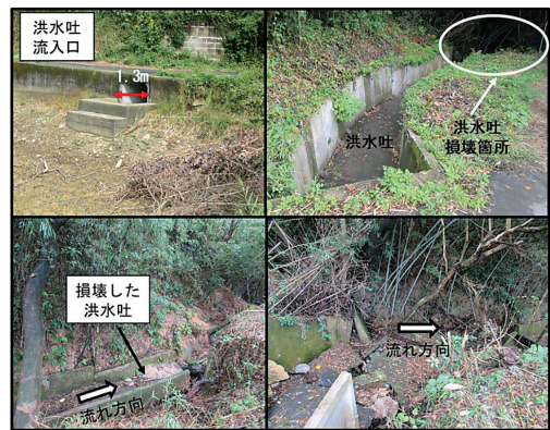
写真2 洪水吐の損壊状況
