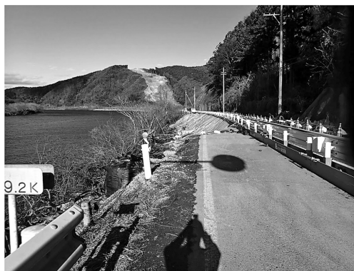
写真3 路肩決壊に車が転落し犠牲者が生じたと推定される位置付近（宮城県石巻市成田成沢）
