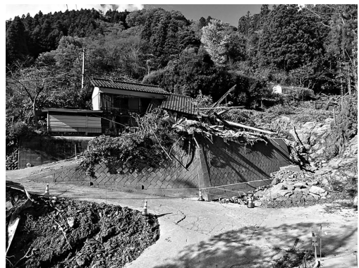
写真2 土砂災害により犠牲者が発生したと推定される地点付近(群馬県藤岡市上日野)
