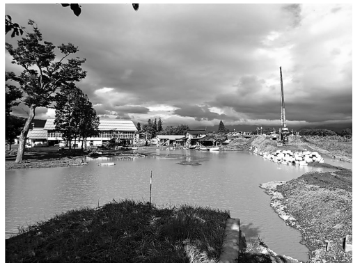
写真11 長野市穂保の千曲川破堤箇所
