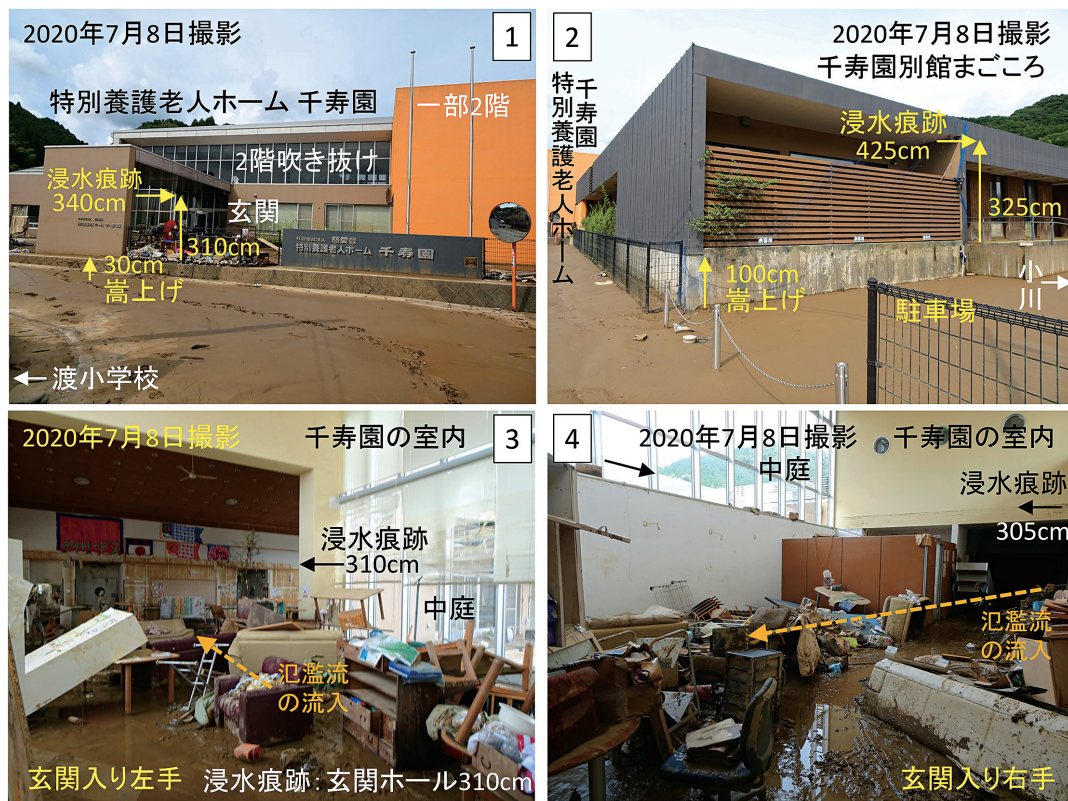
写真4 特別養護老人ホーム 千寿園の被災状況
