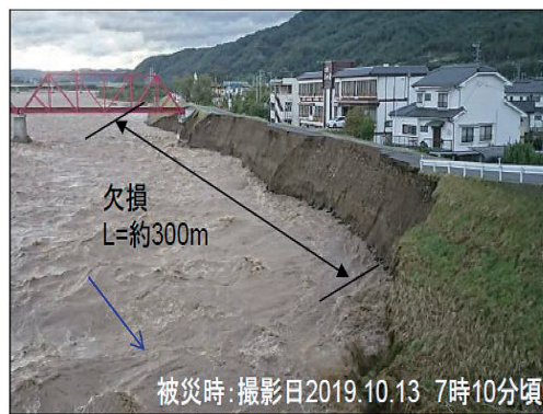
図29 上田市諏訪形地の堤防左岸約300mが洗堀欠損(千曲川河川事務所)
