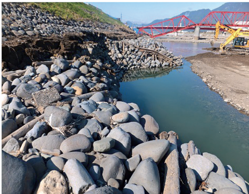
図34 根固め工・木工沈床が洗掘と沈下を受け損壊。遠方の橋脚も傾斜している(著者撮影)
