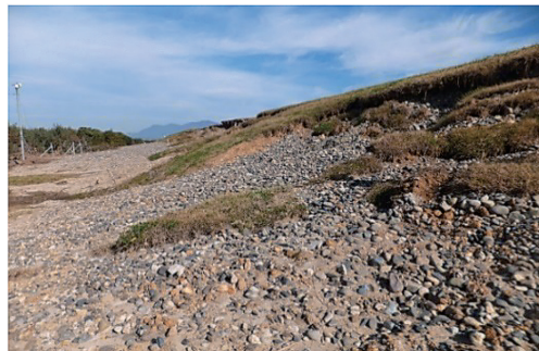
図13 左岸55.5k+133~213 m越水により堤防(側帯)裏のり侵食箇所から崩落した砂利(筆者撮影)
