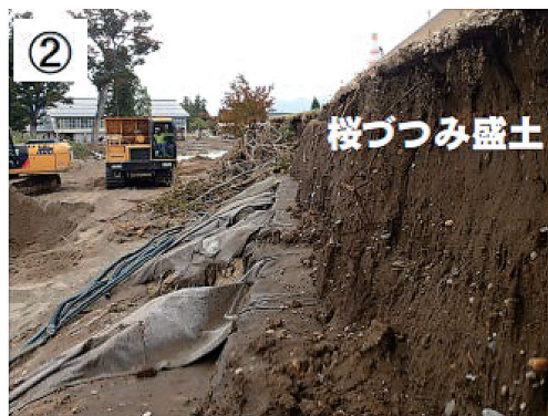
図10 桜つつみ盛土(側帯)崩落地点, ②決壊地点上流側 2019.10.21撮影(国土交通省資料)
