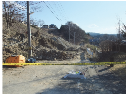
写真12 崩壊した土砂が下部の道路へ与えた被害 (仙台市青葉区北中山)
