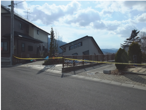
写真10 のり面の崩壊により転倒・崩落した住宅 (仙台市青葉区西花苑)
