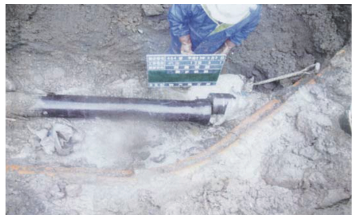
写真5 継手が抜けた水道管 (浦安市, 千葉県の撮影 5) による)
