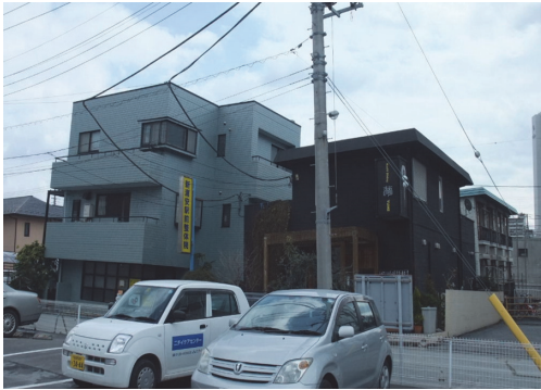
写真2 液状化により沈下・傾斜した家屋 (浦安市)
