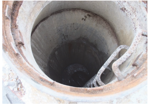
写真4 水平方向にずれた下水道のマンホール (浦安市)
