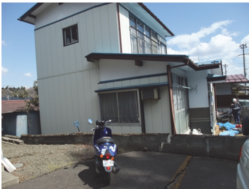
写真14 盛土の移動・すべりによって被災した家屋 (仙台市太白区緑ヶ丘4丁目)
