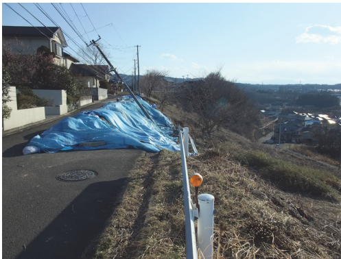
写真11 のり面の崩壊による上部の道路の被害 (仙台市青葉区北中山)
