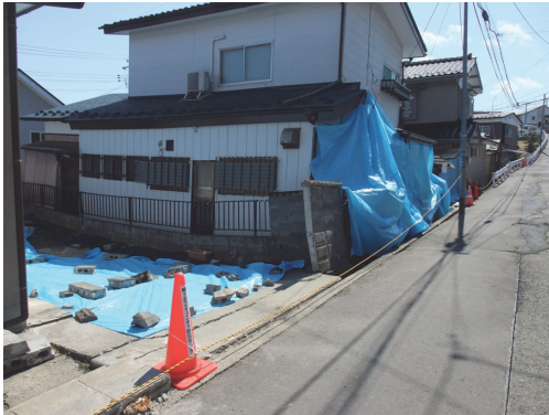
写真13 ひな壇の変形によって被災した家屋 (仙台市太白区緑ヶ丘3丁目)
