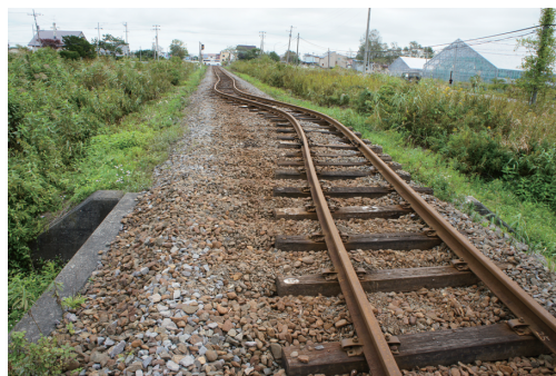
写真9 鶴川近辺の軌道の大きな変位。ただしレールと枕木のゆがみだけで道床の変状は見られない(2018年北海道胆振東部地震)。
