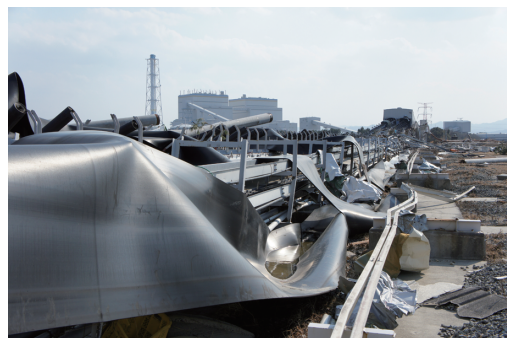
写真1 相馬共同火力発電所の石炭運搬用のベルトコンベアーの被害(2011年東北地方太平洋沖地震)
