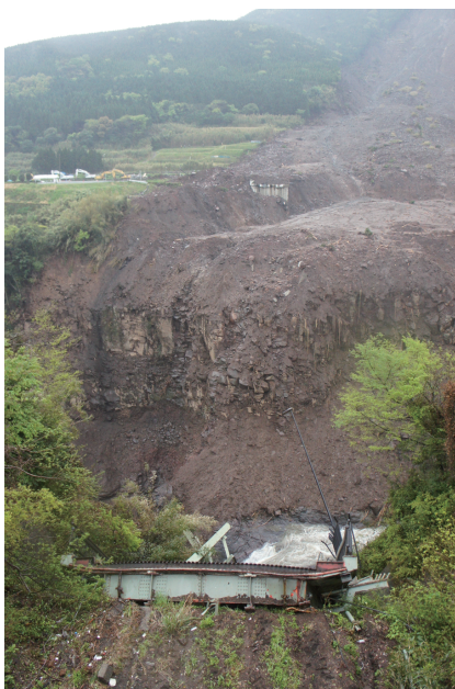
写真4 阿蘇大橋の落橋現場(2016年熊本地震)
