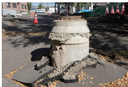
写真8 大規模液状化によるマンホール周辺地盤の沈下(2018年北海道胆振東部地震)
