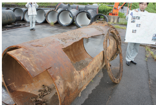
写真6 高槻市におけるダクタイル鑄鉄管の被害(2018年大阪府北部の地震)
