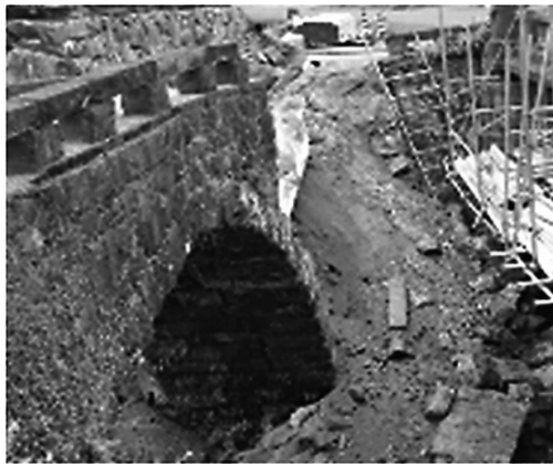
写真1 2016年熊本地震による二俣福良渡の壁面崩壊 2)
