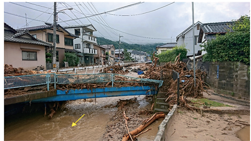
図1 平成30年7月豪雨により流木で閉塞した総頭川の橋梁 (2018年7月8日撮影)
