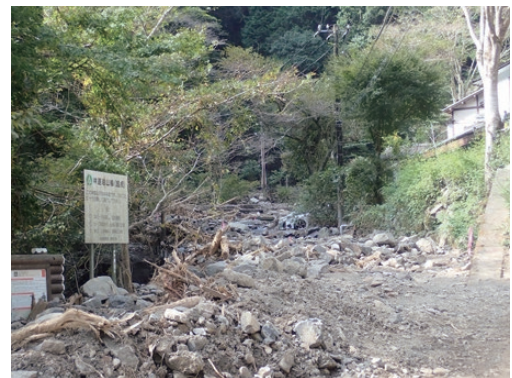
写真22 静岡市葵区油山付近の土砂に埋没した道路，10月4日撮影
