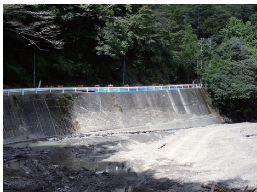
写真4 川根本町下泉の被災現場を上流側から、10月15日撮影
