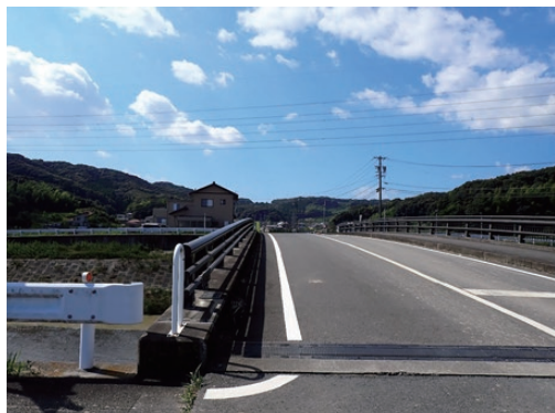
写真9 袋井市大谷の被災現場付近（図19のD地点），9月26日撮影
