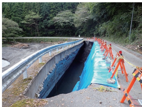
写真3 川根本町下泉の被災現場付近, 10月15日撮影
