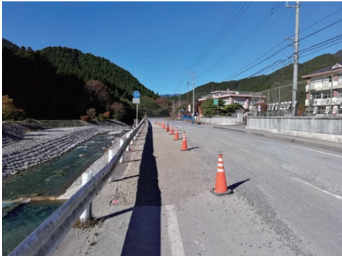
写真6 2019年台風19号による災害で道路の陥没に車が転落して犠牲者が出た現場、栃木県鹿沼市草久
