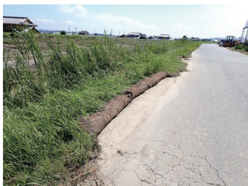
写真8 袋井市大谷の被災現場付近（図19のC地点），9月26日撮影。草が敷地川方向に倒れ根も同方向にめくれ上がっている
