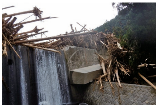
写真2 流木群による砂防堰堤水通し断面の閉塞事例
