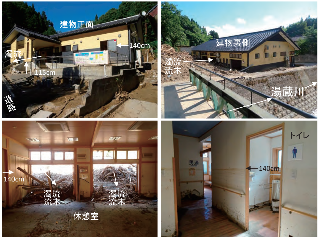
写真6 「荒川いこいの家」の被災状況（2022年8月17日撮影）
