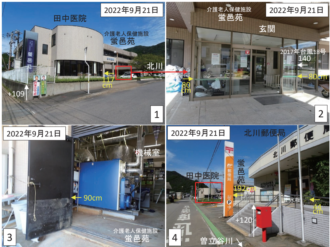
写真7 北川町曾立地区⑦における建物の浸水被害 (写真の位置は図21に記載)
