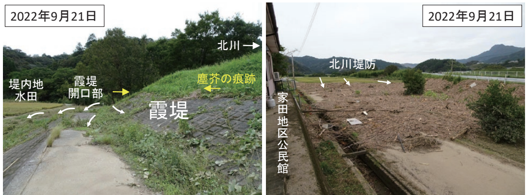
写真8 北川町家田地区⑧の霞堤 (左) と開口部から農地に流入した塵芥 (右) (矢印は霞堤からの洪水流や塵芥の流入方向)
