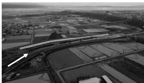
写真1 堤防決壊箇所(矢印は流下方向) (2022年11月筆者ら撮影)
