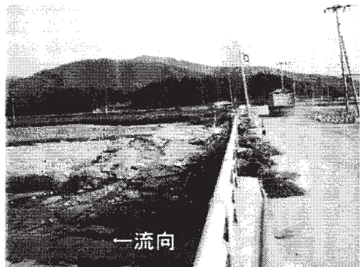
写真 7 中央のブドウ畑の奥が2~3mの段丘崖で、そこまで洪水痕跡がある。橋の下流(左)側に堤高3~4mの堤防があったが完全に流失したとのこと。
