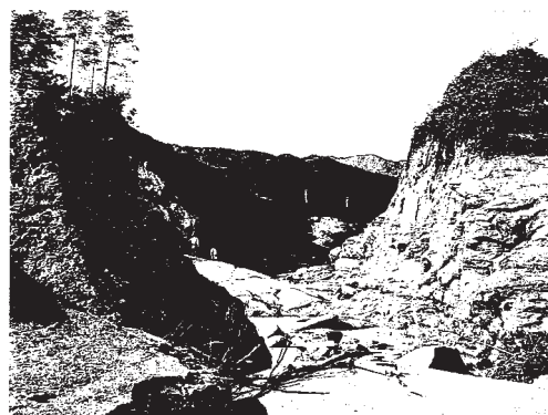
写真1 決壊した余水吐を下流側から見る。取り付け部から完全に流失している。
