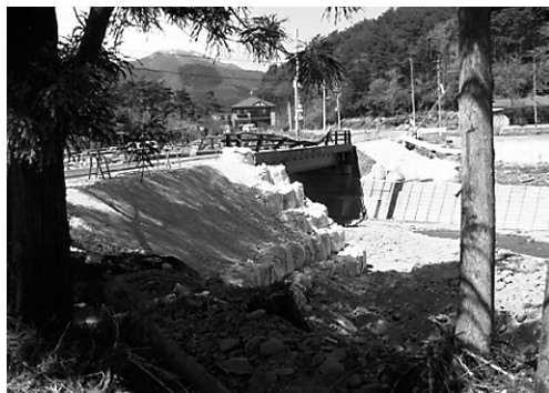
写真11 滝集落下流の橋梁破損
