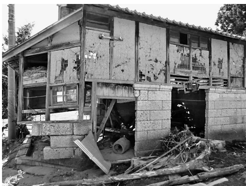
写真8 滝集落家屋の流木による破損
