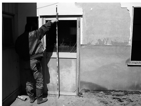
写真6 滝集落家屋の浸水痕跡(浸水約1.5m)
