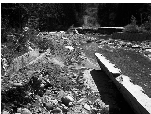
写真10 簗の子川の護岸損傷、および護岸裏込めの土砂流出
