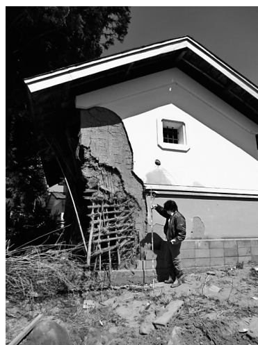
写真7 滝集落家屋の浸水痕跡と破損(浸水約2.0m)
