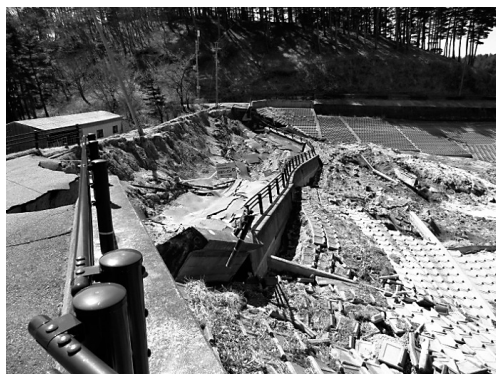
写真1 東側堤体の円弧すべり
