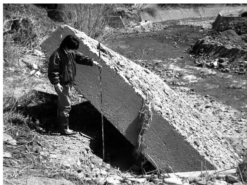
写真12 護岸コンクリート板の流出跡
