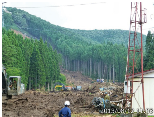
写真1 仙北市田沢湖田沢字供養佛の土石流被災現場
