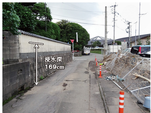
写真4 洪水の水圧により倒壊したフェンスと側壁に見られる浸水痕跡 (位置は図9に記載)
