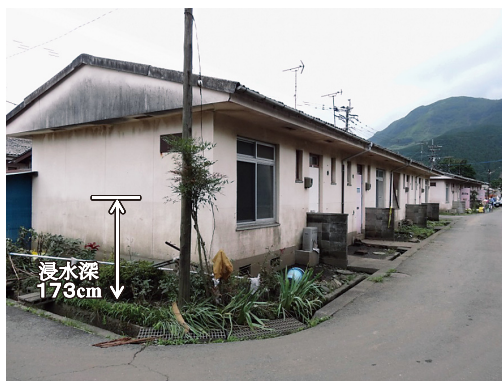
写真3 市営住宅の壁に見られる浸水痕跡 (位置は図9に記載)
