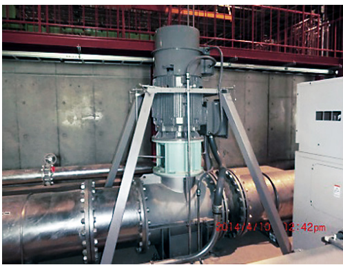
写真3 流れ発生装置のポンプ部
