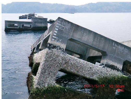
写真1 津波で破壊された釜石湾口防波堤
