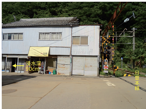
写真9 日豊線沿いの商店における浸水の痕跡(宮本町)(2017年9月28日、山本晴彦撮影)
