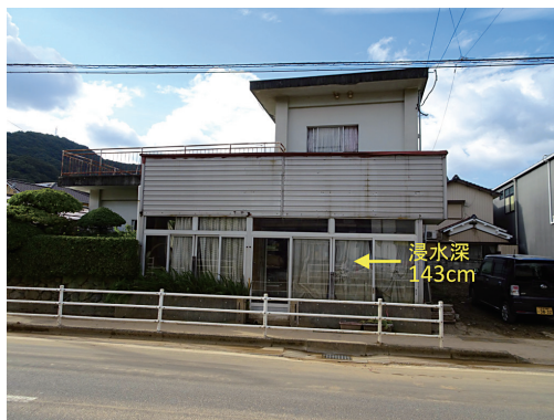
写真10 店舗における浸水の痕跡(中田町)(2017年9月28日、山本晴彦撮影)
