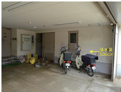
写真3 銀行の駐車場における浸水の痕跡(中央町)(2017年9月28日,山本晴彦撮影)
