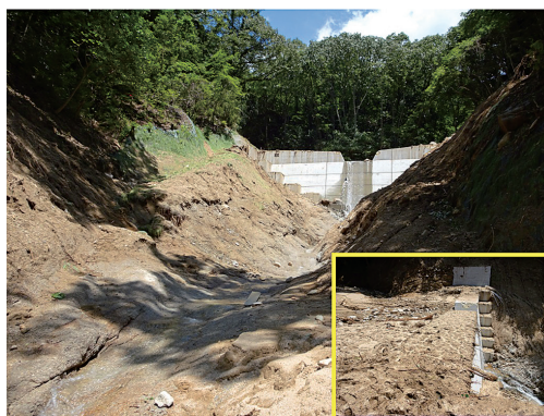
写真7 平成29年に竣工した治山ダムと土砂が堆積した堤内の状況 (2018年7月10日撮影)
