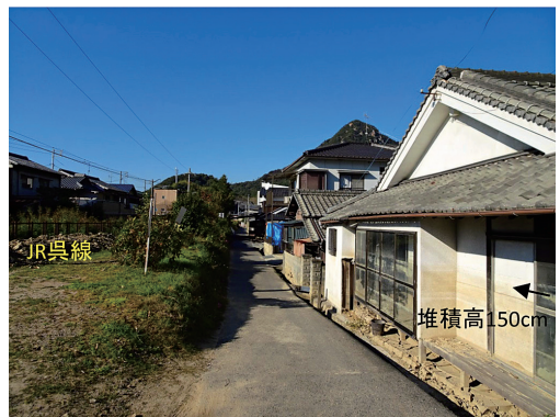
写真14 大屋大川の氾濫により土砂が堆積した住宅の被害 (2018年11月4日撮影)
