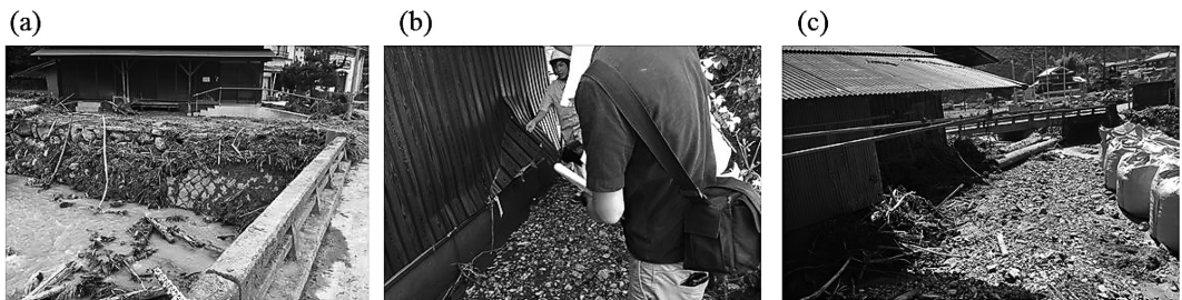
写真1 宍粟市河原田公民館周辺 左岸側 (a) 左岸側迂回流が流下した痕跡(2018.7.13), (b) 左岸側家屋の洪水痕跡(2018.7.13), (c) 左岸側家屋の浸水被害(2018.7.13)
