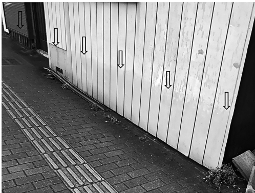
写真14 竹の久保町県道沿いの家屋の浸水痕跡
