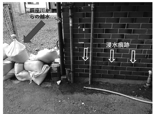
写真4 銅座川左岸側の浸水痕跡(2019年3月25日著者撮影)
