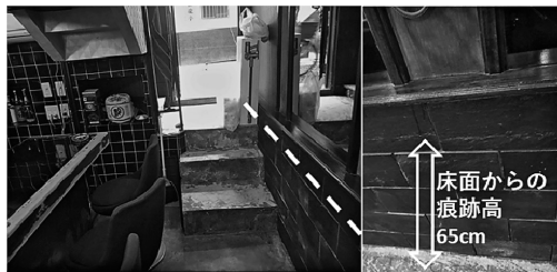
写真6 半地下の飲食店の浸水痕跡 (2019年3月25日著者撮影)
