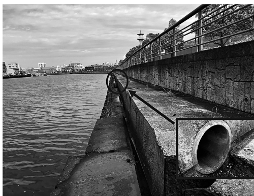
写真10 浦上川左岸河口付近に設置されている排水管。(2019年4月5日、著者撮影)
