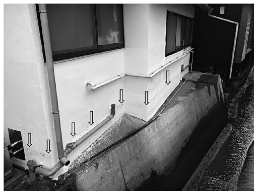
写真13 竹の久保川右岸側の家屋に付着した浸水痕跡
