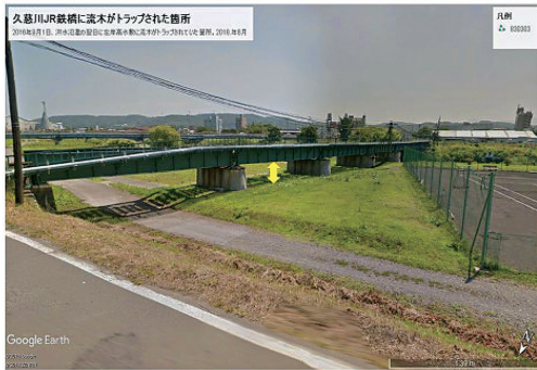
図6 JR鉄橋に流木が捕捉された水害2年後(2018年6月)の同一箇所の原状復旧状況
