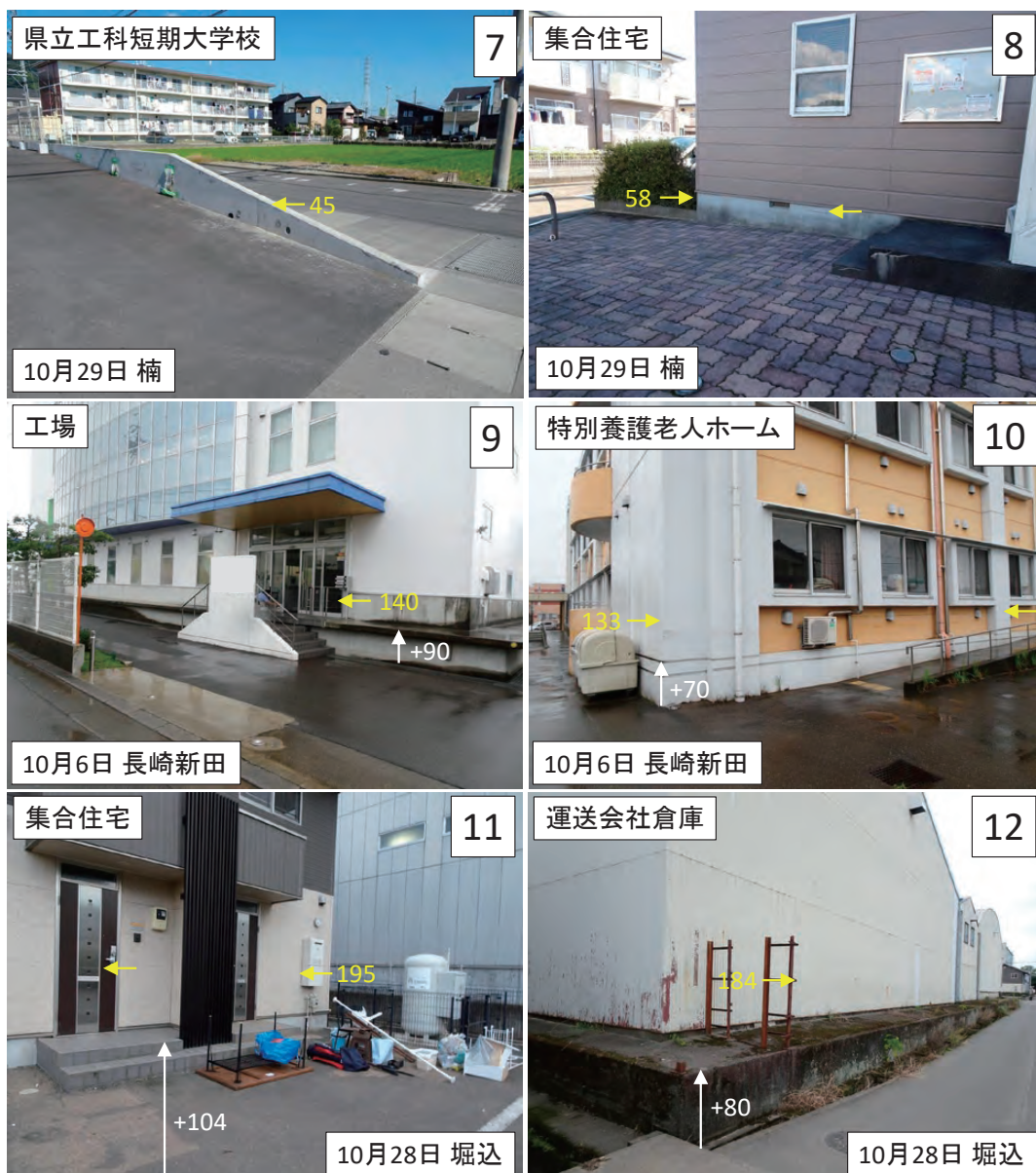
写真1 [7]~[12] 楠・長崎新田・堀込における浸水被害の状況(地盤からの高さ (cm))
