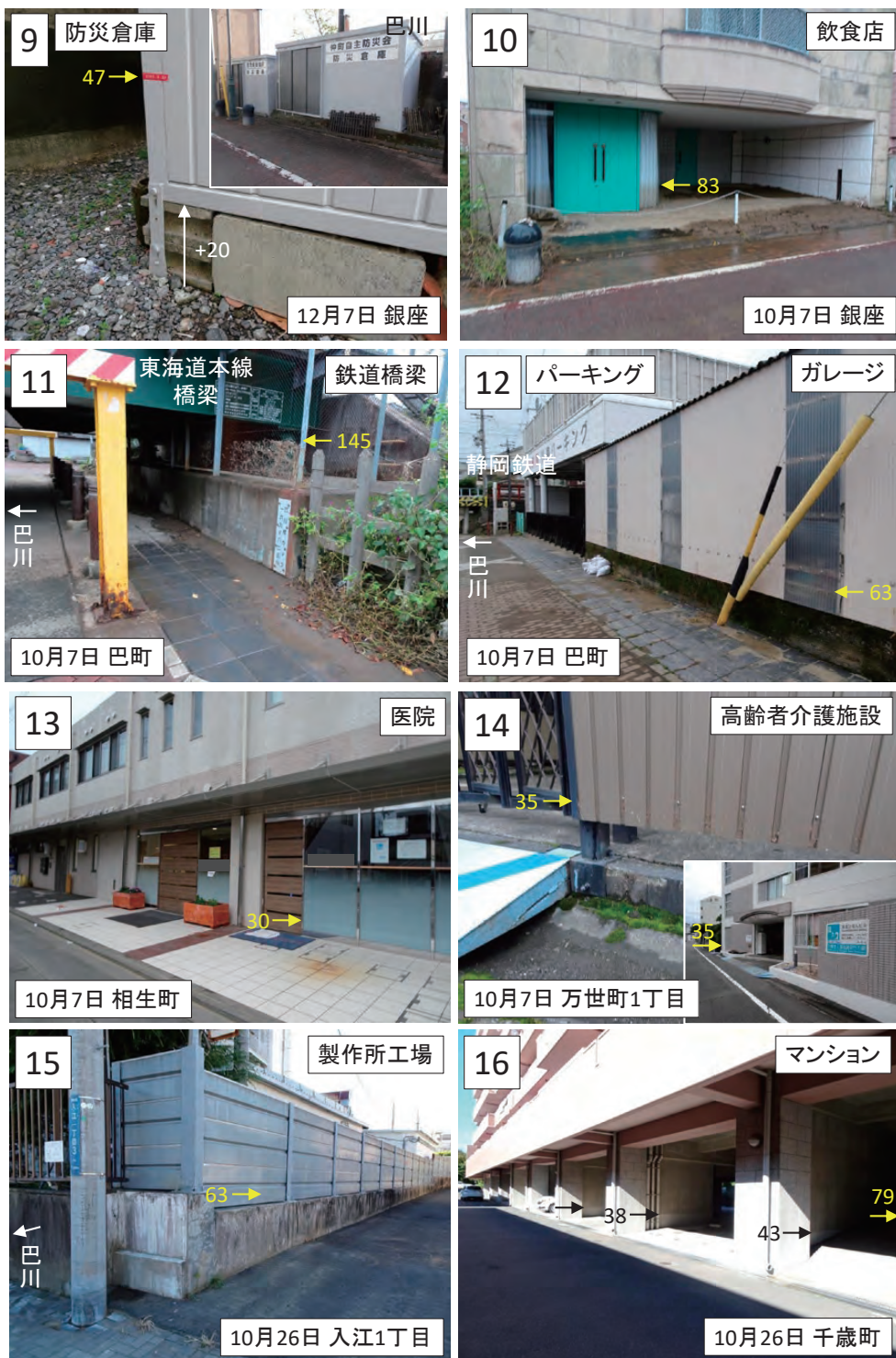
写真3⑨～⑯ 銀座・巴町・万世町1丁目・千歳町・入江1丁目における浸水被害の状況(地盤からの高さ(cm))
