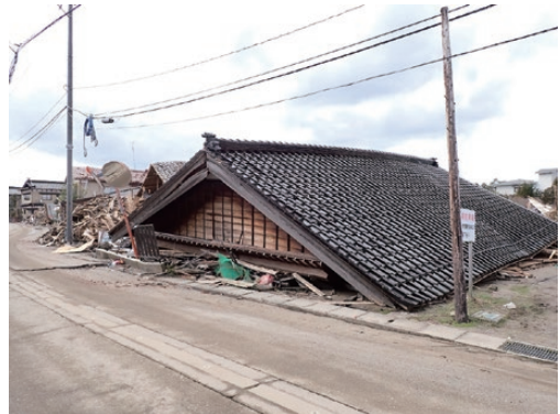
写真1 「倒壊」家屋の例。建物が建っていた位置から移動せず倒壊している。珠洲市宝立町鶴飼, 2024年2月9日撮影
