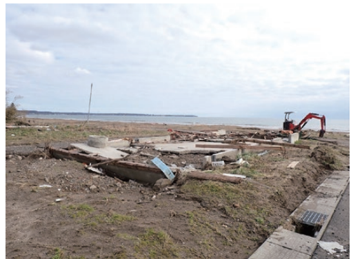
写真2 「流失」家屋の例。基礎のみが残り、建物は元の場所に存在していない。なおこの建物は住宅地図などから住家等ではないと判断され、本稿の建物被害判読の対象外である。珠洲市宝立町春日野, 2024年2月9日撮影
