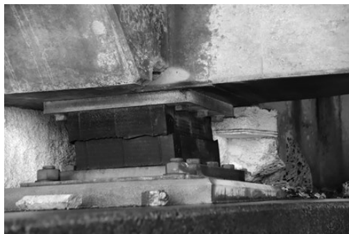
写真9 天神橋における積層ゴム支承の破断
