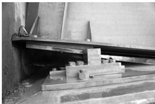
写真8 花山橋における積層ゴム支承の被害
