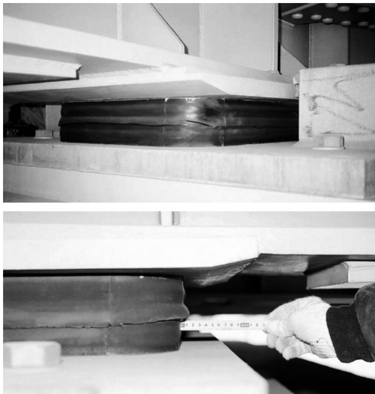
写真2 西宮浜工区におけるゴム支承の損傷
