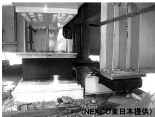
写真3 東部高架橋における積層ゴム支承の破断
