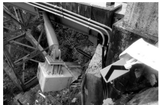
写真6 南阿蘇橋におけるダンパー取付部の破断
