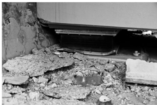
写真7 烏川大橋における積層ゴム支承の被害
