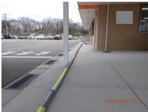
写真2 N-1園に設置された排水用パイプ
